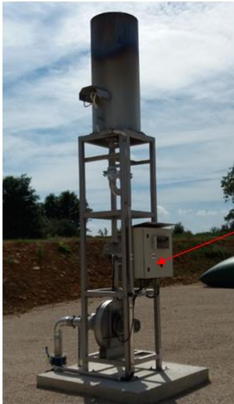
Figure 6. Localisation des vannes de coupures au niveau de l'Epurateur et du Compresseur (exemple tiré d'une installation similaire, AGRIKOMP)
